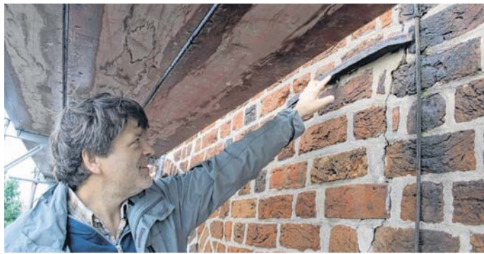
Torsten Eilrich und seine Kollegen finden so manchen Riss – aber auch die Anker, mit denen schon früher das Tor gesichert wurde.
