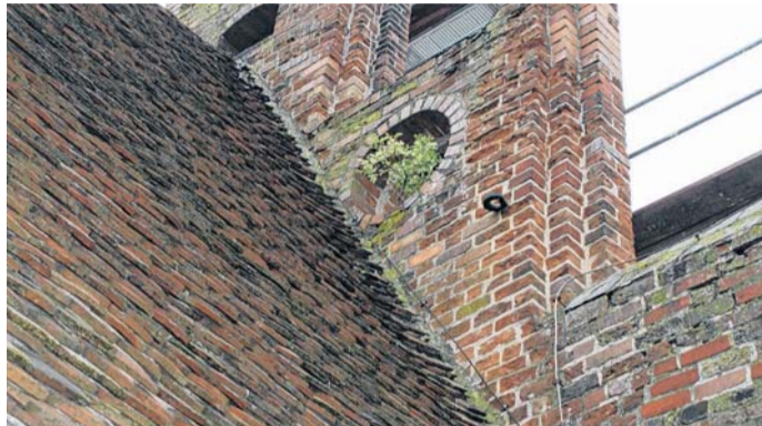
Das Dach ist stark sanierungsbedürftig – was nicht nur an den schon aus Nischen wachsenden Bäumchen zu sehen ist.
